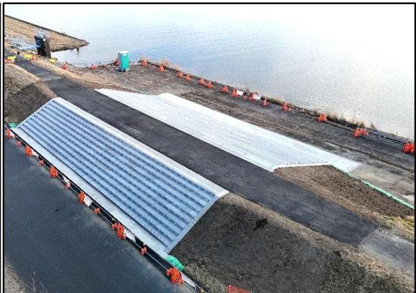
【北利根川左岸 2. 3 km】
