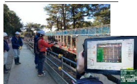
AI配筋検査システムの活用
